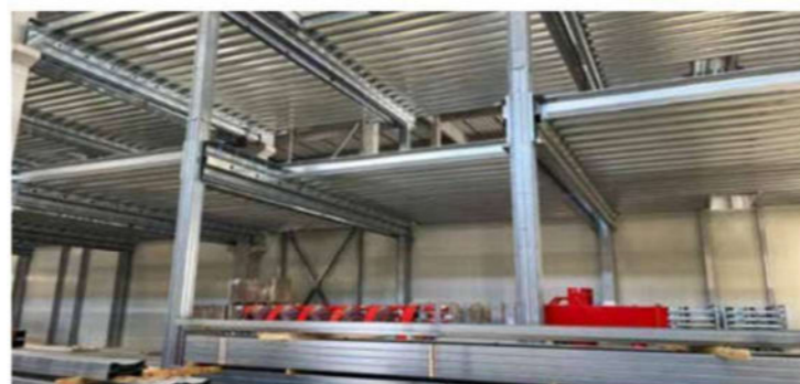
Staalframeprofielen voor de inrichting van een fulfilment center.
